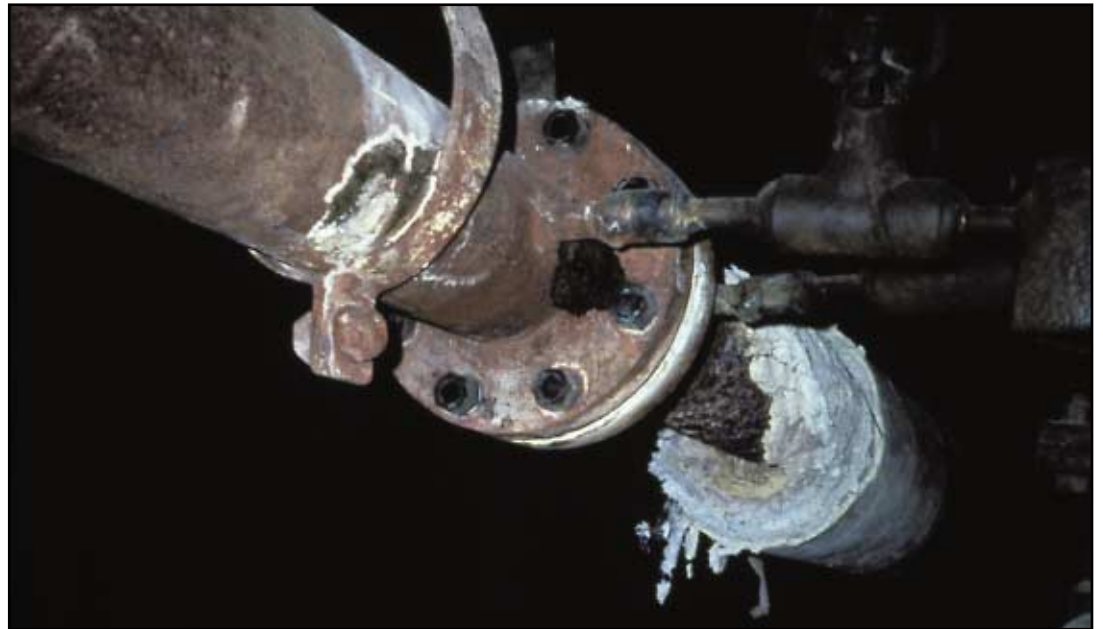
Canalisation de vapeurs avec calorifugeage et joint en amiante.
